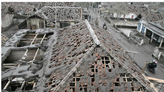
Gambar 1. Kerusakan Pemukiman di Dusun Kutut. (Sumber: BPBD Kab Malang, 2014).
